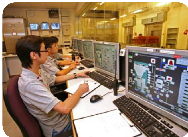
鑽石山火葬場監察火化爐運作的控制室
