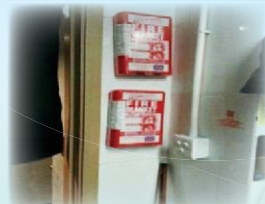
滅火氈即時可供使用
